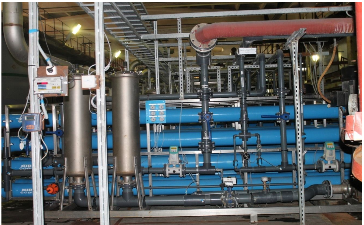
Рисунок 21 - Установка обратного осмоса
