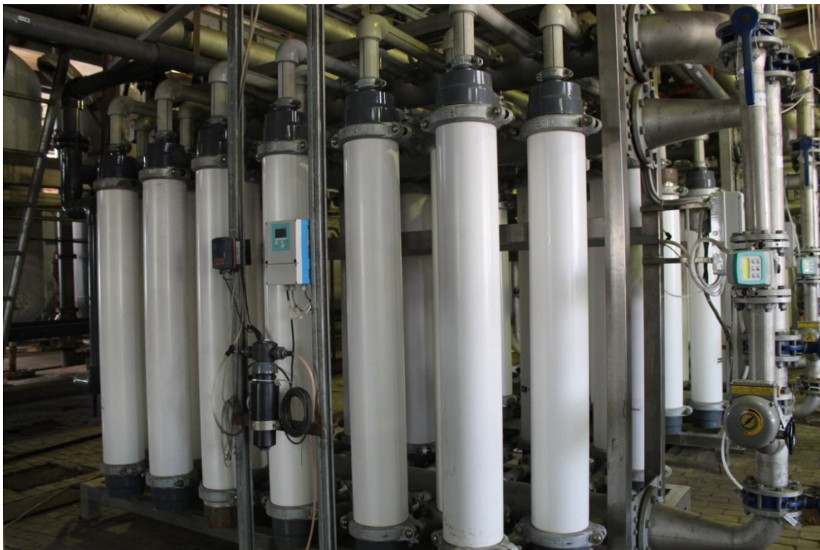
Рисунок 14 - установка ультрафильтрации (5) – UF-03, UF-04 UF-05 UF-06
