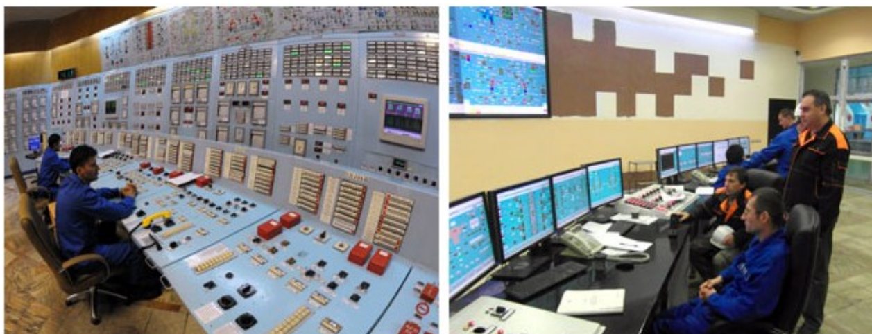
Рисунок 15. Щит управления энергоблока
