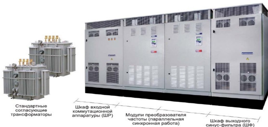
Рис. 8. Высоковольтный преобразователь частоты для насосной станции четвертого подъема НФС-3
