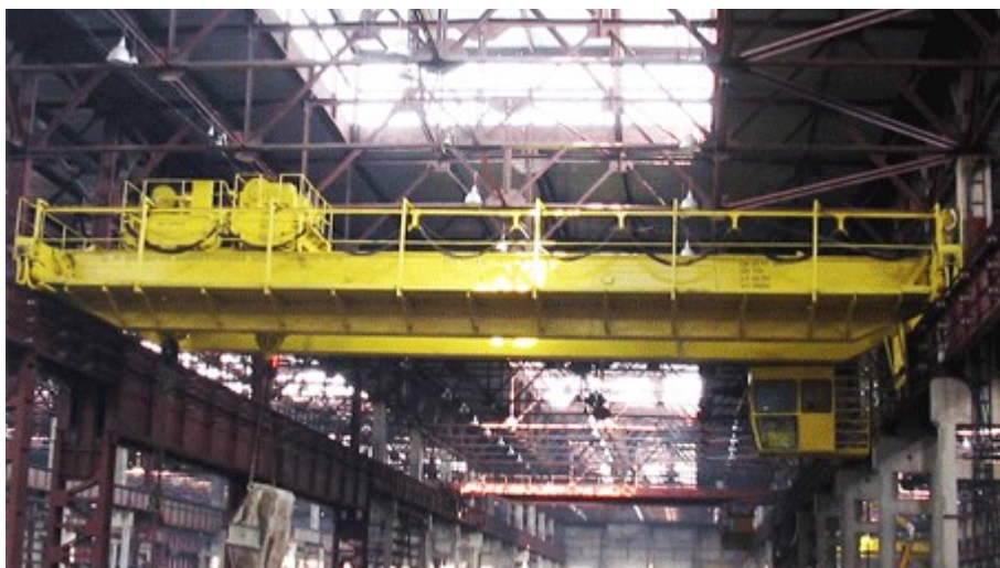
Рисунок 1.1 - Общий вид мостового крана
